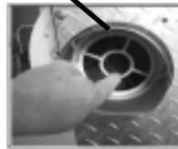
6" Stainless Inlet pipe DS
